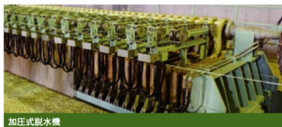
加圧式脱水機
